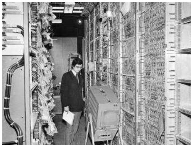
Le central téléphonique de l'aéroport de Roissy Charles-de-Gaulle en cours d'installation en octobre 1971. AFP
